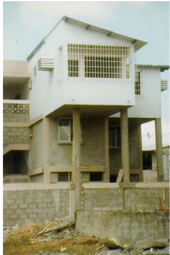
Un tipo de estructura con alto riesgo sísmico son algunos de los condominios del BEV en Sauces IX, en los que se han introducido ampliaciones sin diseño y supervisión técnica. (Tomado de los archivos del IIFIUC - Universidad Católica, Proyecto FUNDACYT-BID).
